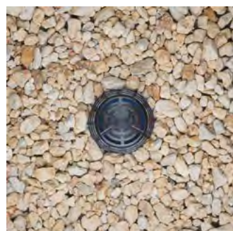
Gully mit Kiesfang im Flachdach
